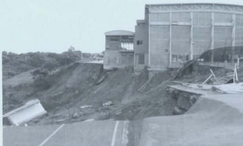
網球場崩落現場
